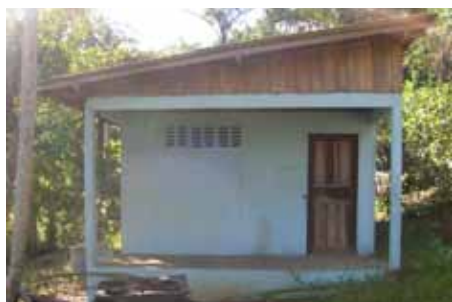
Figura 1: Utilização de madeira de modo inapropriado.
